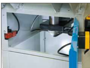
La caja cambio velocidad con microinterruptor
