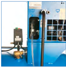
Secador preinstalado y conectado
